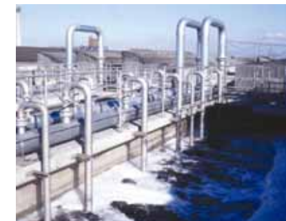
排水処理施設
