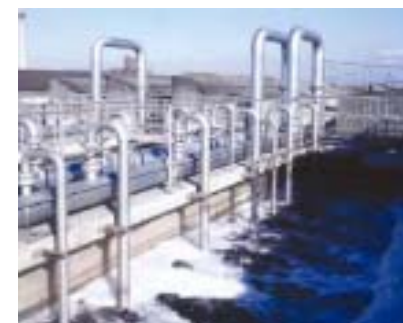
排水処理施設
